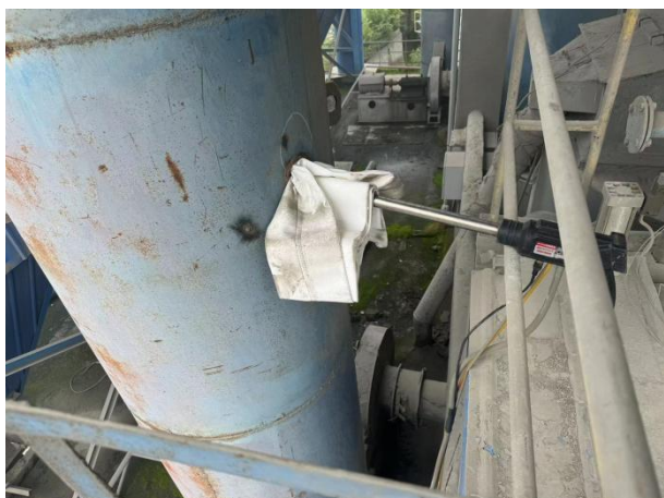
图 1: ●1#DA001 废气排气筒
